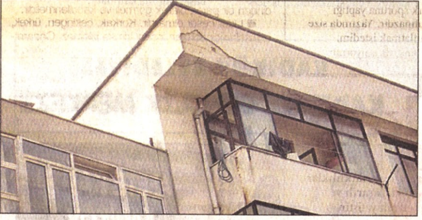
Yan binadan dökülen beton parçaları tehlike oluşturuyor...
